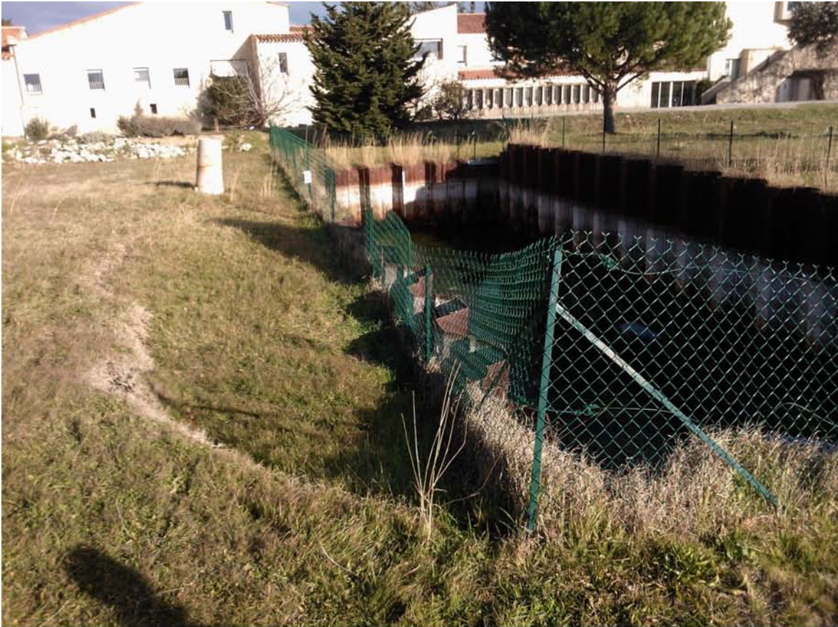
■ Fig. 6 : Affaissement des palplanchs (2013) et système de renforcement mis en place (2014)
