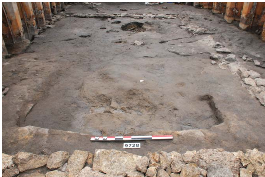
■ Fig. 52 : Vue d'ensemble, depuis l'ouest, de la maison en construction (UNF143) de la phase 1S, avec des amas de terres de nature différente (limon, argile, terre malaxée) liées au chantier.
