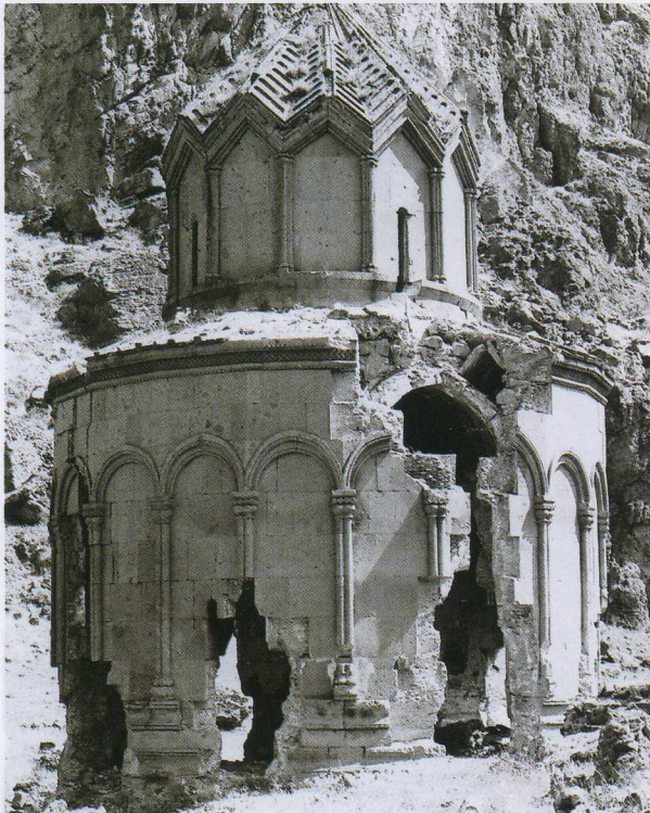
Foto 38. Surp Sarkis Kilisesi, 1980 ve 2013 tarihli fotoğrafların mukayesesi: Külahtan doğuya doğru çatının yıpranması.
