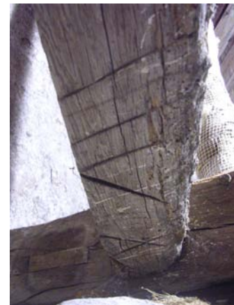
Marque d'assemblage sur un bois réemployé
