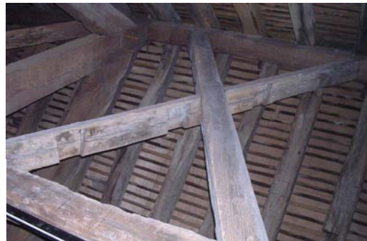
Sablière avec ses entailles à mi-bois à demi-queue d'aronde pour l'assemblage des blochets des fermes secondaires
