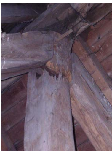
Rupture de la tête du poinçon de la deuxième ferme, liée au surpoids de la ferme et à la faible section du poinçon
