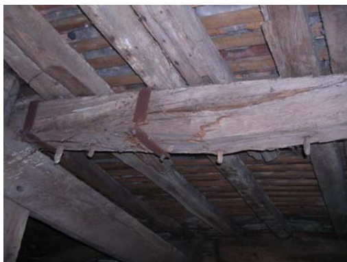
Cette panne brisée semble avoir été réparée également en 1888 par des cerclages métalliques.
