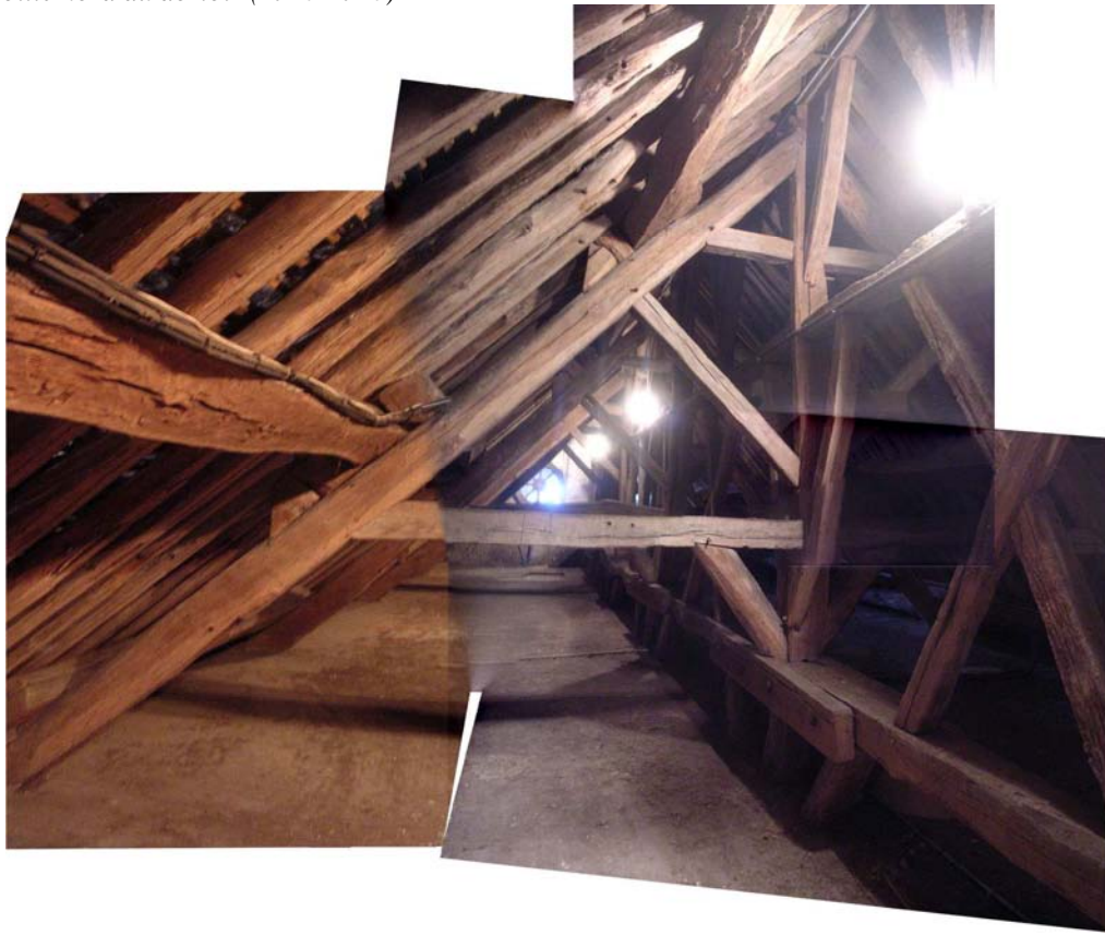
Partie haute d'une ferme de la charpente D1, sur la moitié nord du dortoir (1710-1720)
