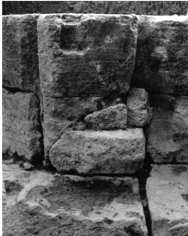
Fig. 18 – Les deux feuillures verticales du côté nord de la pile centrale avec traces d'érosion sur le parement et le dallage (© Mission de Ras Shamra).
