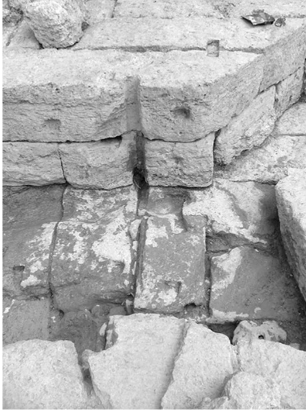
Fig. 17 – Feuillure verticale du côté sud de la pile centrale (© Mission de Ras Shamra, cliché F. Onnis).
