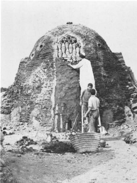
c — four n° 1 : obturation de la porte arrière.
