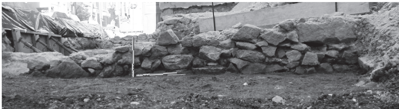
Fig. 43: le parement est du mur MR 2040 vu depuis l'est (cliché B. Paris/CAV).
