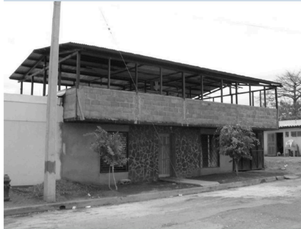
Figura - 3 Inmueble construido dentro del marco de un programa financiado por la Unión Europea según normas parasísmicas en el barrio de San Sebastián en el 2000. Un año más tarde, el propietario del inmueble ya había emprendido de manera completamente ilegal trabajos de ampliación, lo que hacía a su vivienda muy peligrosa en caso de sismo (Foto: S. Hardy 2001).
