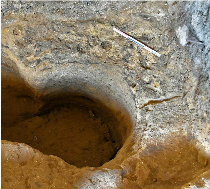
Fig. 20 – Boutique N20. Vestiges de la citerne située au nord-est de la pièce N20/2-3.
