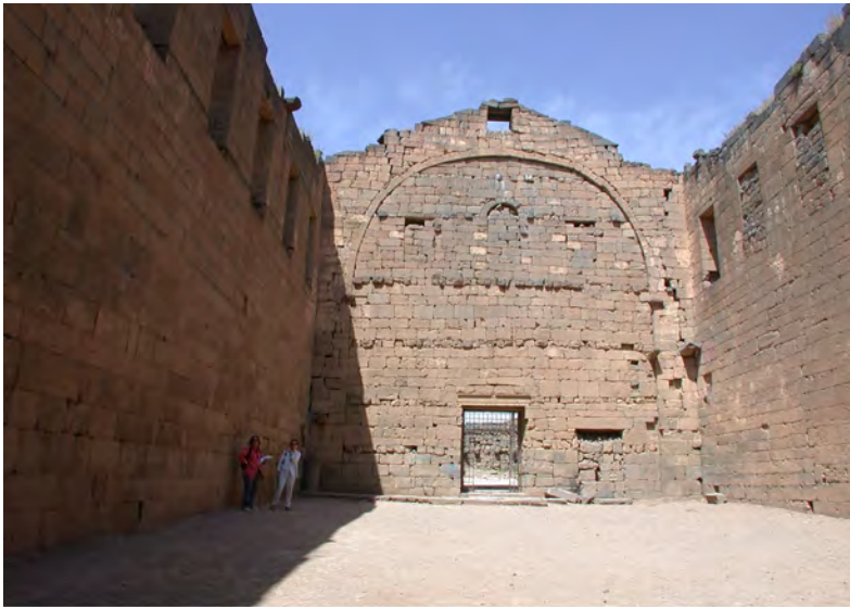
Fig. 57 : Basilique de Bahîra, façade intérieure ouest, état en 2003 (en haut) et en 2012 (en bas, cliché «Sham»), avec deux excavations.
