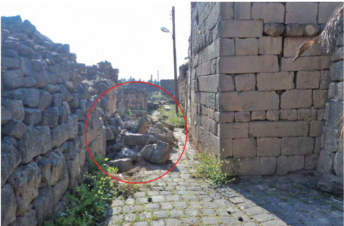
Fig. 46 : Ruelle entre la mosée d'Omar et la mosquée de Fâtima, éboulement d'une partie de la façade sud.
