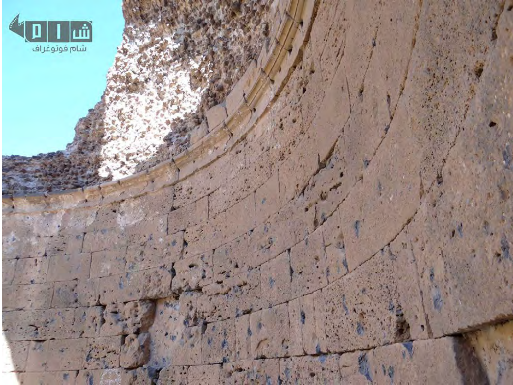
Fig. 59 : Basilique de Bahîra, détail de l'élévation intérieure est (abside), traces d'impacts (cliché «Sham», 2012).
