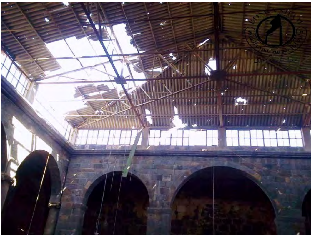
Fig. 53 : Mosquée d'Omar, vue intérieure de la couverture de la salle de prière
