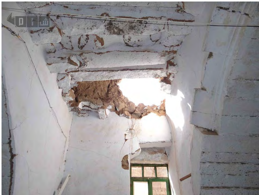
Fig. 13 : Mosquée de Fâtima, lacune dans la couverture de la salle de prière
