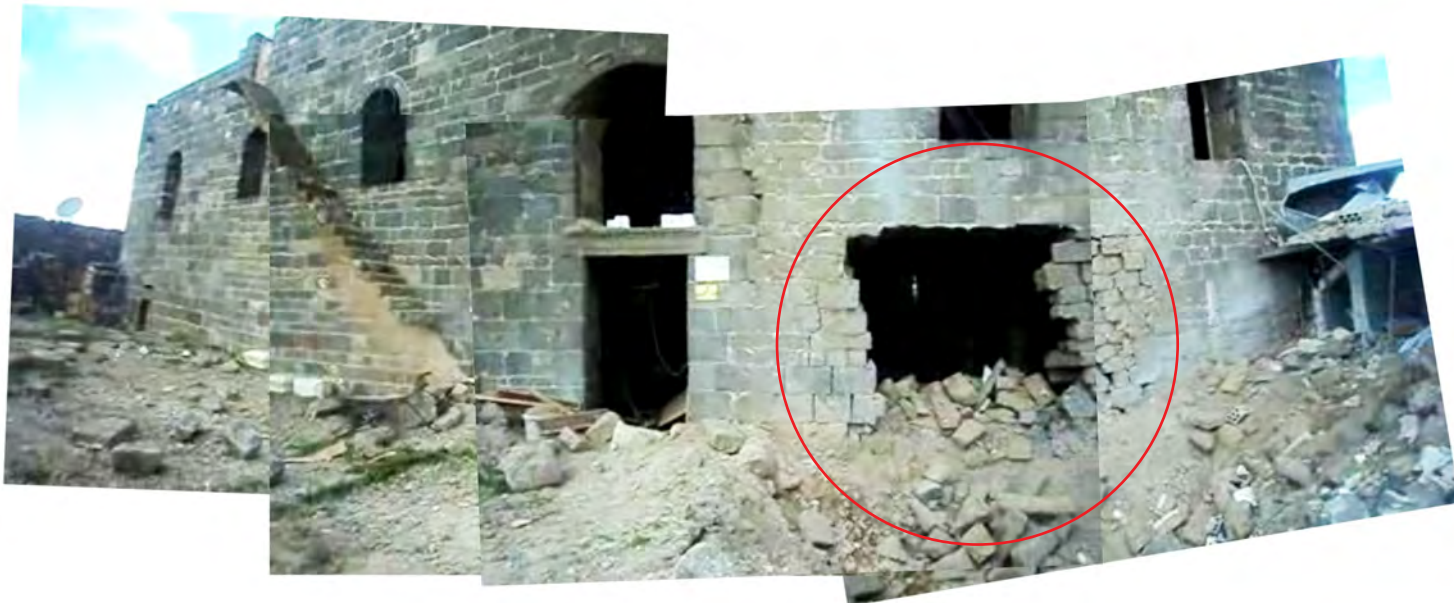
Fig. 49 : Mosquée d'Omar, façade ouest éventrée par l'explosion d'un baril de TNT (clichés extraits d'une vidéo du 12 avril 2015)
