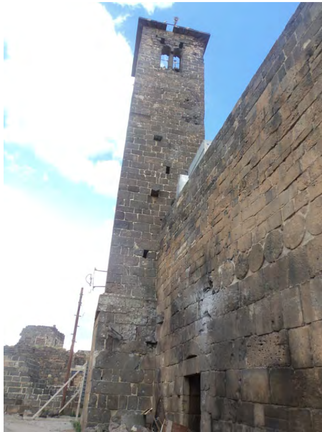
Fig. 47 : Mosquée d'Omar, impacts sur la façade nord.
