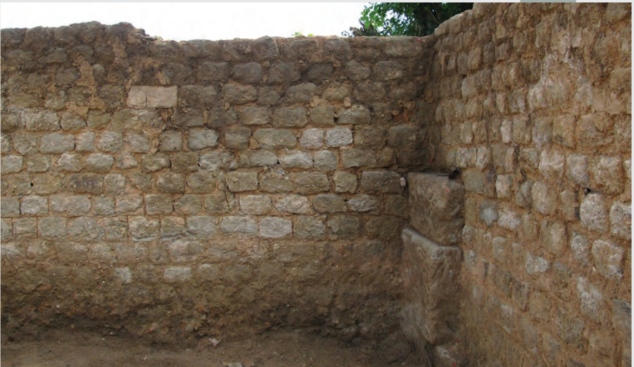
Fig.2 Parement du second état (angle sud du théâtre). (cl A. Tisserand, SAVA)
