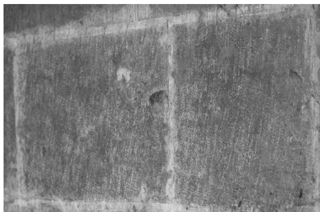
Figure 8 : Exemple de dressage au marteau brettelé. Le badigeon des joints est particulièrement lisible (© L. Gaugain).
