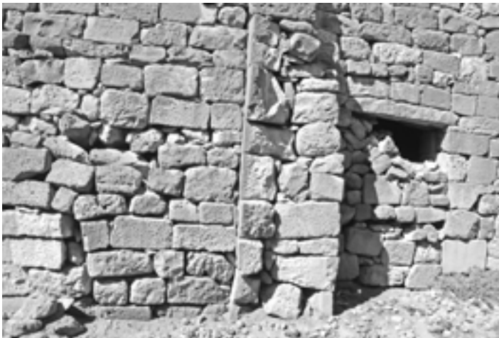
Fig. 5 - Bosra : restes de l'arc coupés sur le côté nord de la rue actuelle.
