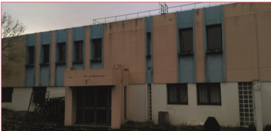
Figure 14 – Entrepôt vétuste à Aulnay-Sous-Bois, Source : Diagnostic Aulnay-sous-Bois, 2018
