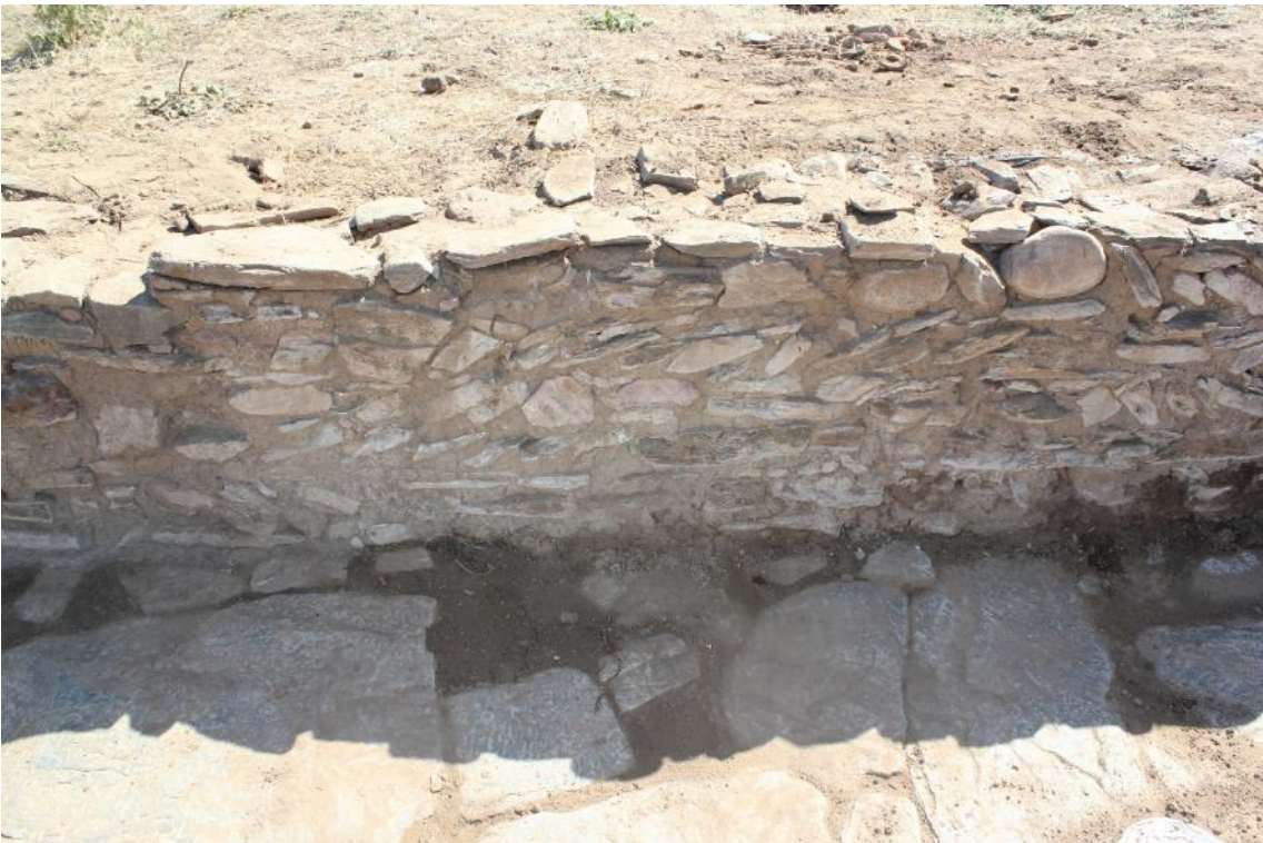
Fig. 2. Piedras que se encontraban sueltas sobre el muro, colocadas durante la campaña de 2014.
