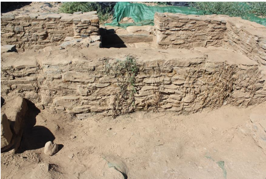
Fig. 3. Plantas superiores que han crecido sobre el muro, aprovechando roturas en la lona de plástico.
