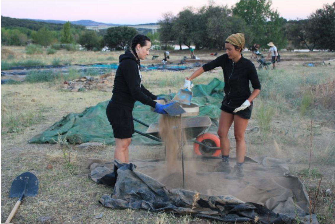
Fig. 15. Cribado de la tierra de la propia excavación, para la preparación del mortero.
