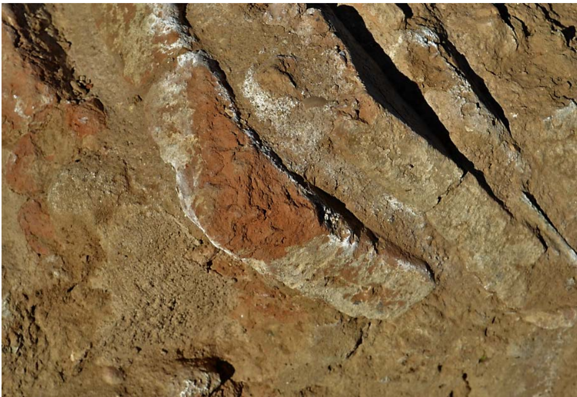
Detalle del estado de un ladrillo.
