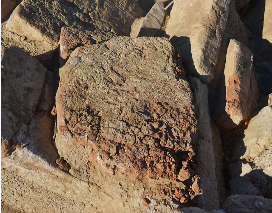
Estado de meteorización y disgregación de los ladrillos, a pesar de estar consolidados con silicato de etilo durante campañas anteriores.
