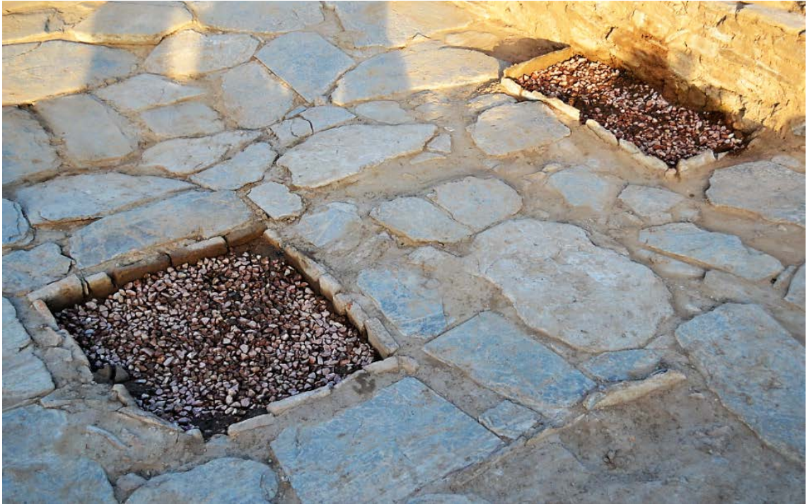
Estado de conservación de la grava.
