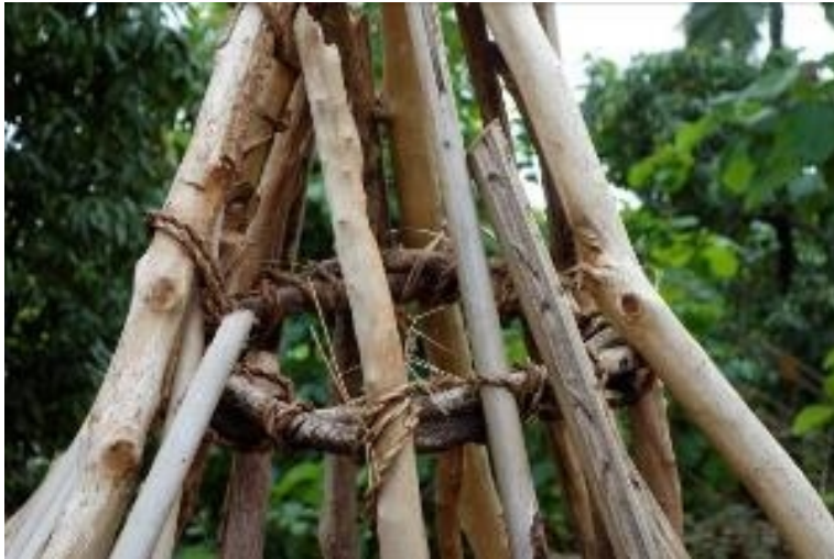
Figure 5: Interior ring bunkar on a damaged roof (Orodara region, June 25, 2016) Anneau intérieur bunkar visible sur un toit détérioré (Région d'Orodara, 25 juin 2016)
