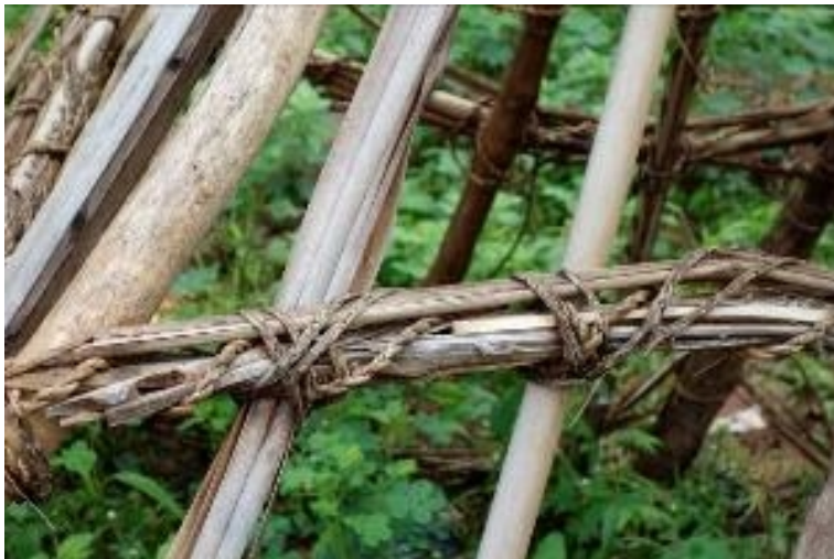
Figure 6: Interlacing kaar-ja mon on a damaged roof, Orodara region (June 25, 2016) Entrelacement kaar-ja mon visible sur un toit détérioré, région d'Orodara (25 juin 2016)
