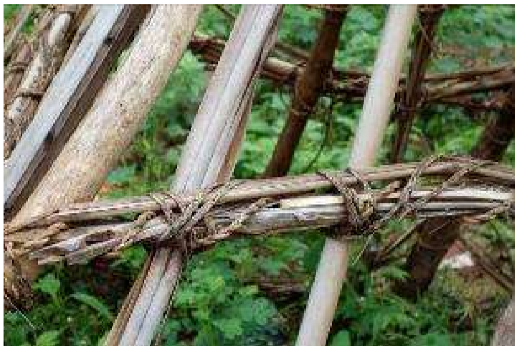
Figure 6. Entrelacement kaar-ja mon sur un toit endommagé, Orodara, 25 juin 2016
