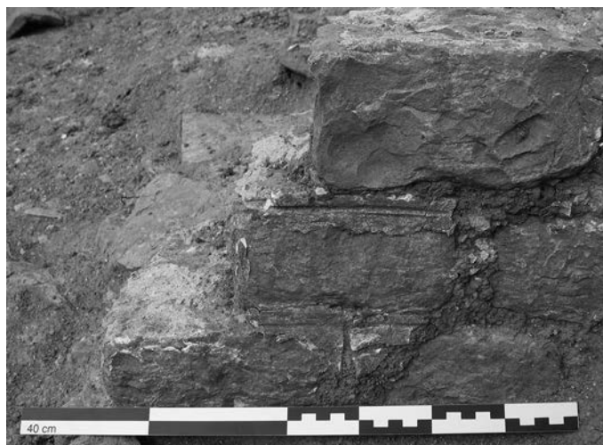
Fig. 7 – Porterie : détail de joints tirés au fer sur la façade extérieure, à l'angle des murs 788 et 789 (cliché : S. Jeandemange, Inrap).
