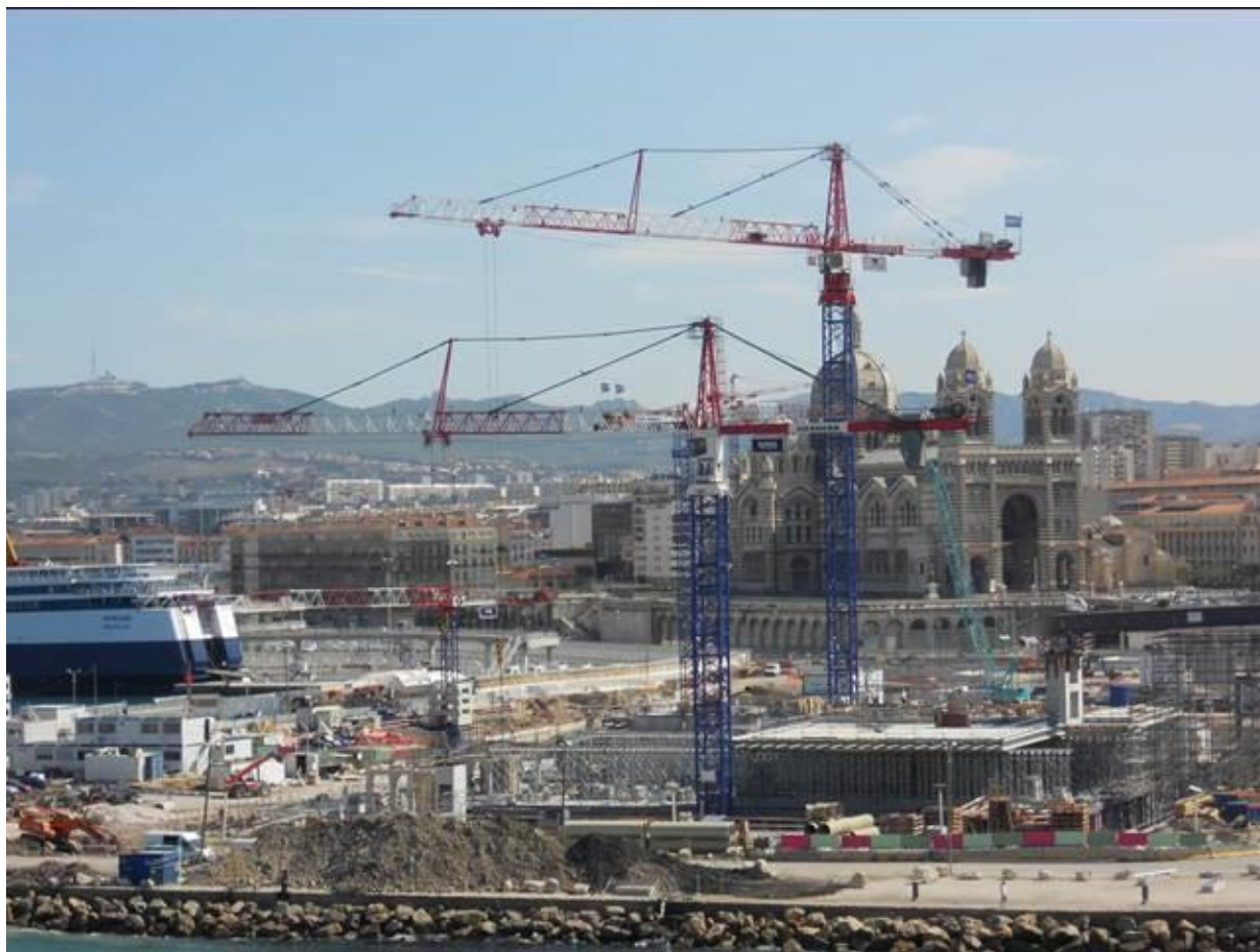
Les travaux de construction du MuCEM sur le J4 (juillet 2011), voir aussi le reportage de Marseille web TV où Bruno Suzzarelli fait le point sur les travaux http://www.marseilletv.fr/sitevideo/jsp/site/Portal.jsp?document_id=1208&page=viewdocument&viewdocumenttype_id=2
