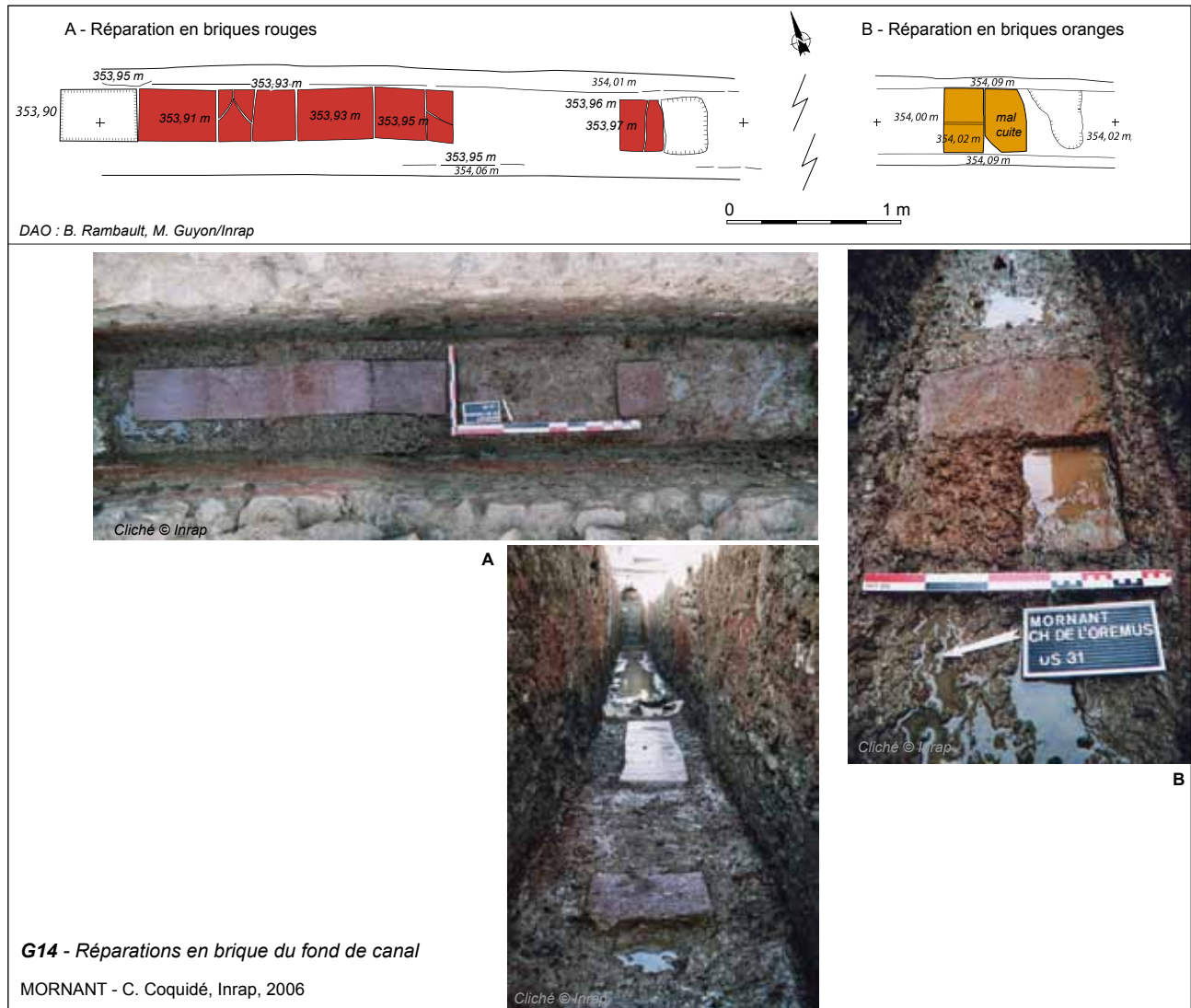
Fig. 32. Les anomalies et réparations antiques, fond du canal.
