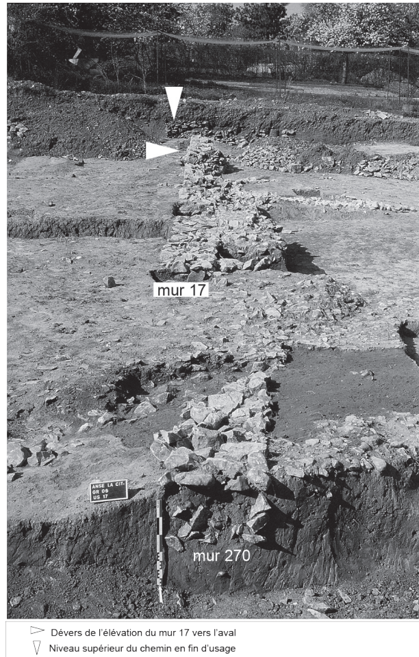
Fig. 194 - La Citadelle, période 1 – état 3: aile est, dévers du mur US 17 vers l'aval sous la poussée des sédiments accumulés sur le chemin (cliché: équipe de fouille).
