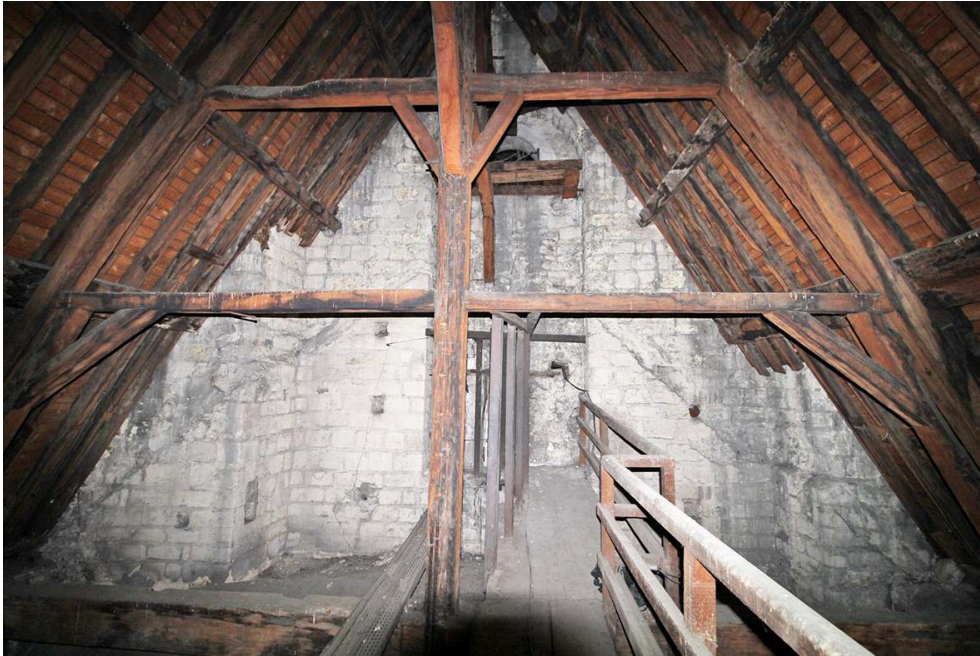
Fig. 9 – Tour Morard (face orientale). Charpente du XVII e siècle et engravure de l'ancienne toiture de la nef
