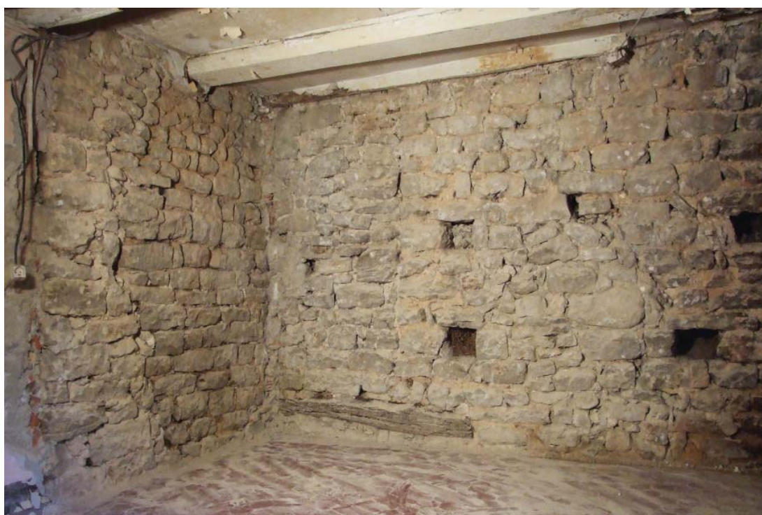
Fig. 14 : Zone 1, troisième étage, mur MR1001 avec le linteau en bois de l'ouverture du deuxième étage
