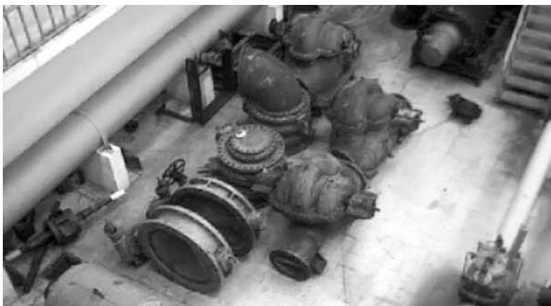
FOTO 5.3. EQUIPO DETERIORADO DEL SISTEMA LERMA
