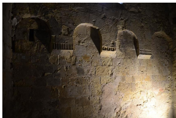
Castellane, chapelle Saint-Thyrse de Robion. Vue de détail des arcatures aveugles sur le mur pignon ouest de la nef (SDA 04).
