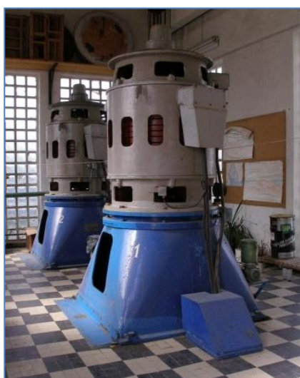
Les pompes d'Albaron renvoient au Petit Rhône les eaux de Corrège et Camargue Major
