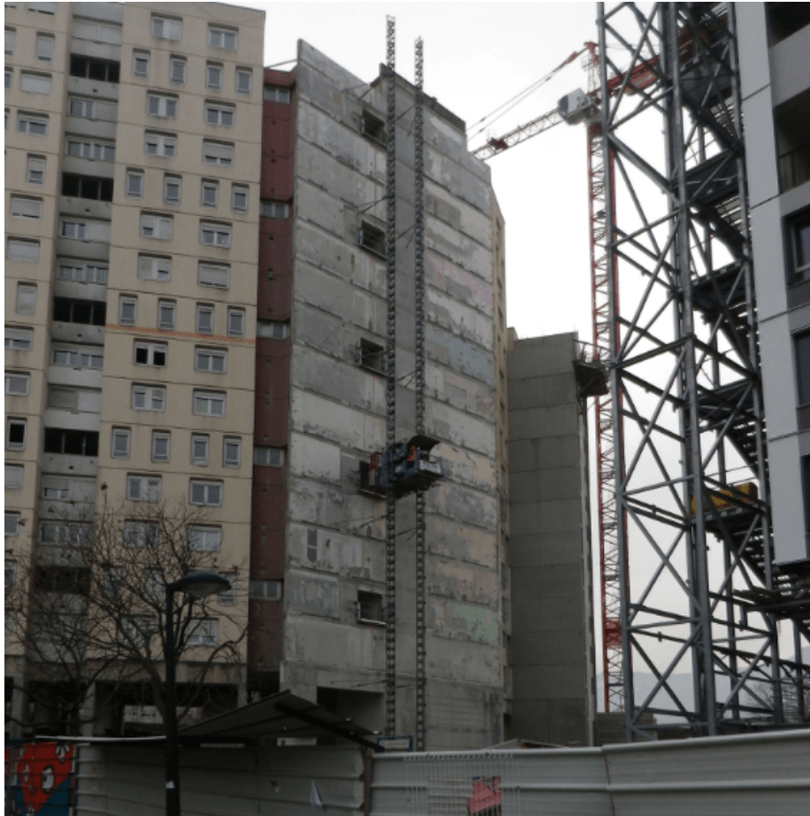
Figure 2 : Photographie des traces de la démolition sur la façade du 50 Arlequin, Villeneuve de Grenoble, le 28 janvier 2016.
