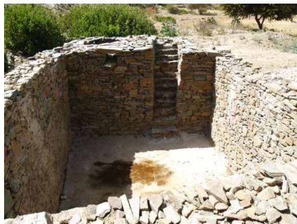
FIGURE 9.6 – Citerne en pierre sèche et fond maçonné en bordure de parcelle, à l’amont du dispensaire, vallée de May Ayni. Cliché : N. Blond, 2014.
