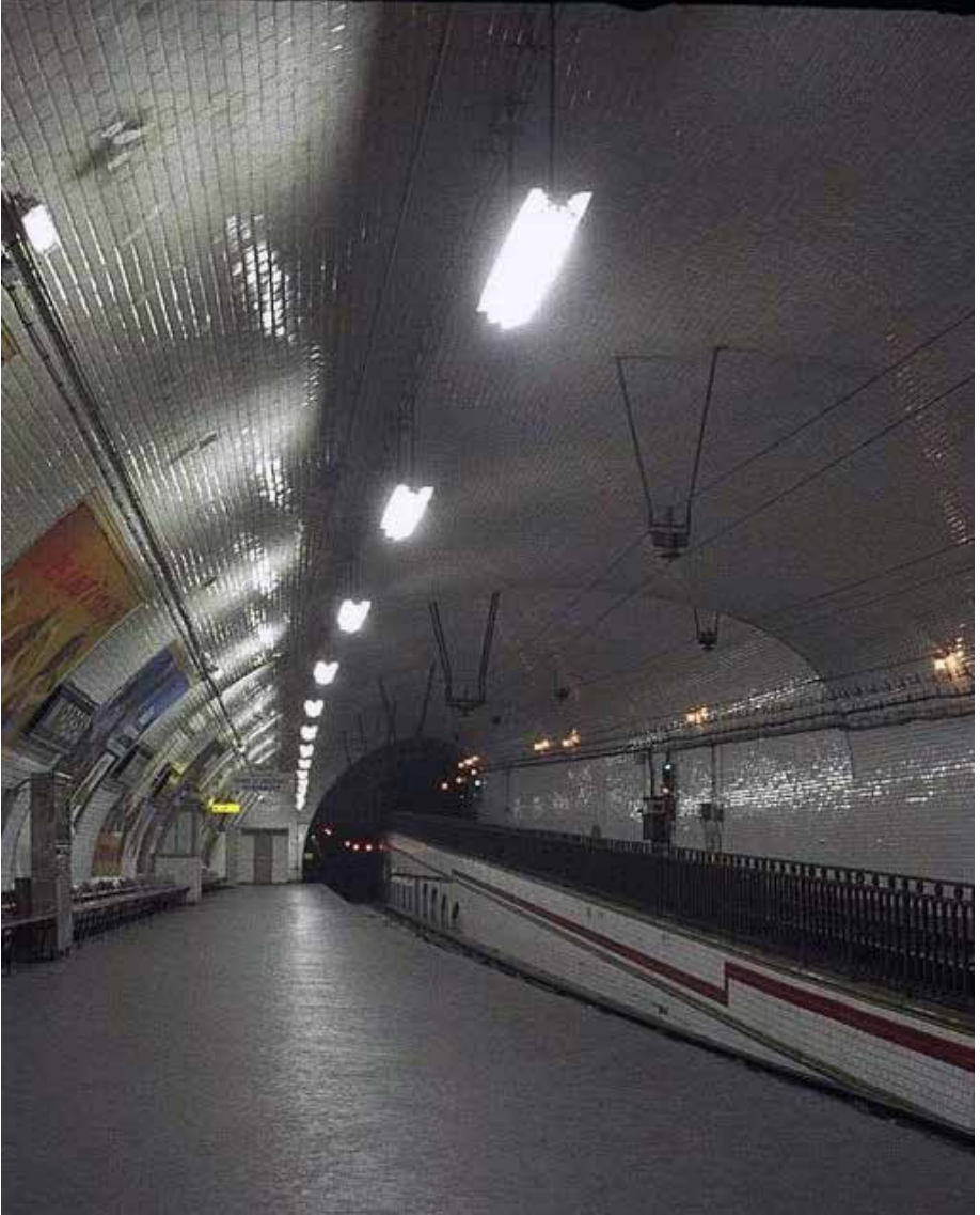
Station Mirabeau en 1979 : la vue permet d'observer le montage du feeder de l'éclairage normal avec son négatif de la partie supérieure (Harald Jahn)
