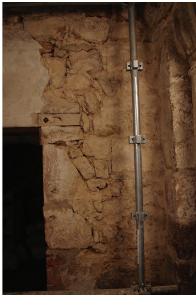
a. Chaînage en grand appareil et césure périmétrale autour de la porte actuelle.
