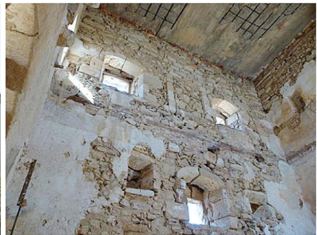
Fig. 5c - Façade nord, vue intérieure des deux derniers étages (Cliché V. Rinalducci, CNRS)
