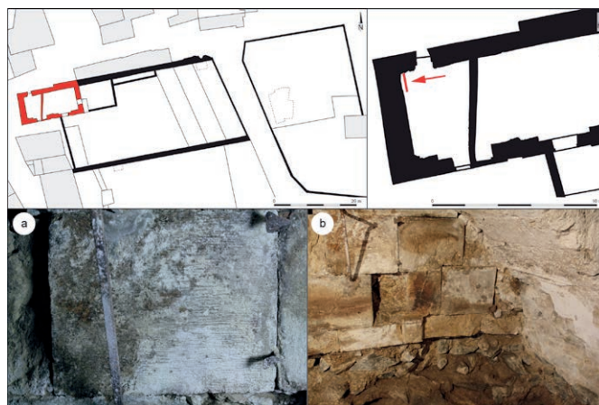
Fig. 14 Emprise de l'avant-nef, étude du bâti : détail du revers de façade avec des traces de layage horizontal sur un bloc de calcaire blanc (a) et des dalles de pierre retailées au moment de la mise en œuvre (b) (cl. Olivia Puel, 2009).
