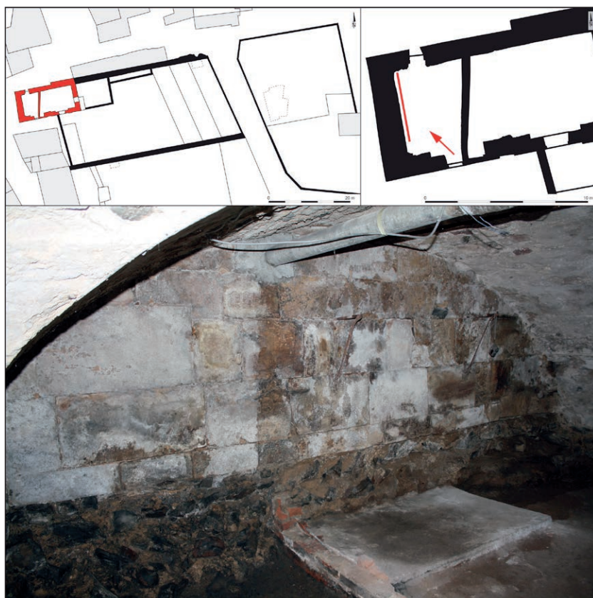
Fig. 11 Emprise de l'avant-nef, étude du bâti : vue générale du revers de la façade occidentale. En bas, les fondations démaigries jusqu'au nu du mur; en haut, l'élévation en placage de dalles de pierre de taille. L'omniprésence du salpêtre sur les blocs de pierre empêche de distinguer les différents matériaux de construction (cl. Olivia Puel, 2009).
