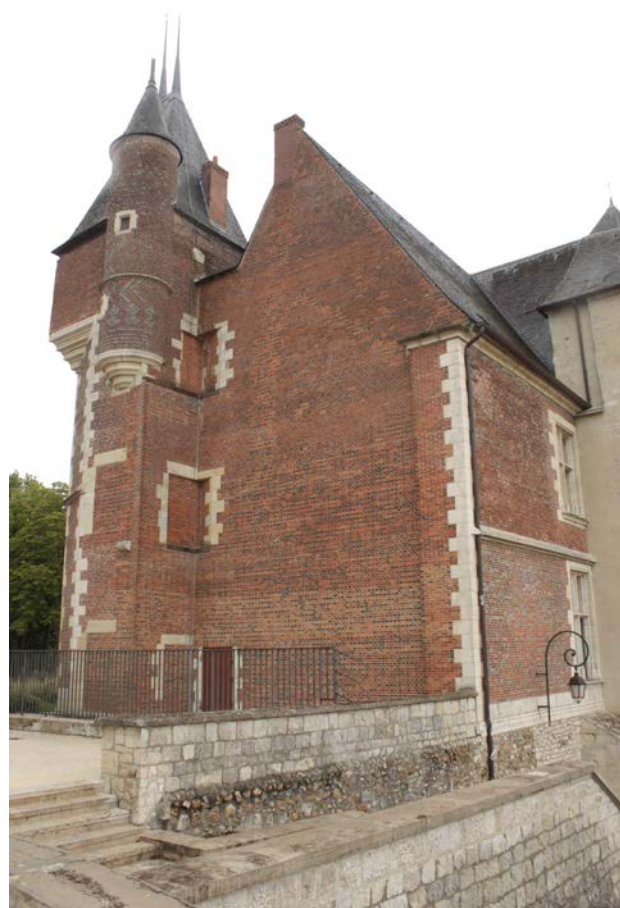
Fig. 1 : Vue du pignon ouest avec les seuils de portes menant à l'aile ouest disparue © Mélinda Bizri.
