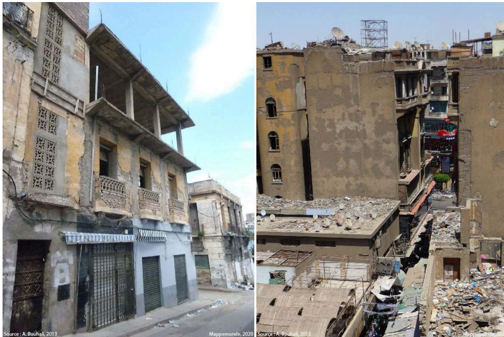
Figure 5. Deux exemples d'immeubles dégradés parmi d'autres : à gauche à Médina J'dida et à droite au Muski
