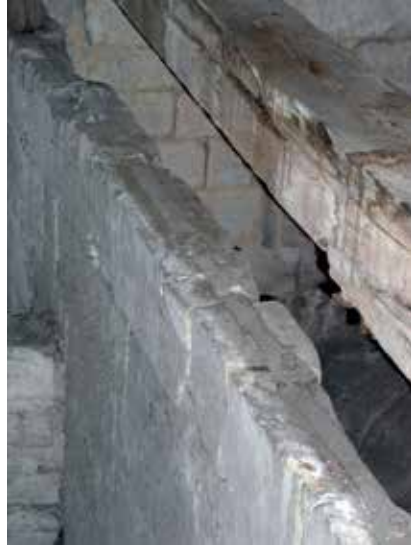
Fig. 5 – Chaînage ancré sur un mur diaphragme au-dessus des voûtes du chœur de la cathédrale de Beauvais (Maxime L'Héritier).
