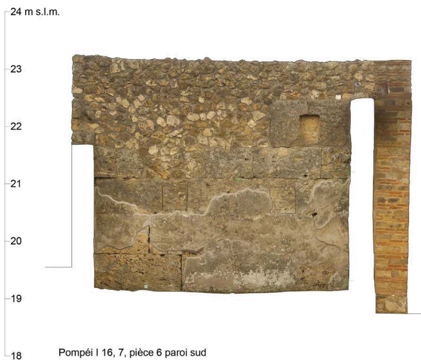
Fig. 7. Photogrammétrie de la paroi sud de la pièce (6) de I 16, 7, avec indication des fenêtres bouchées.
