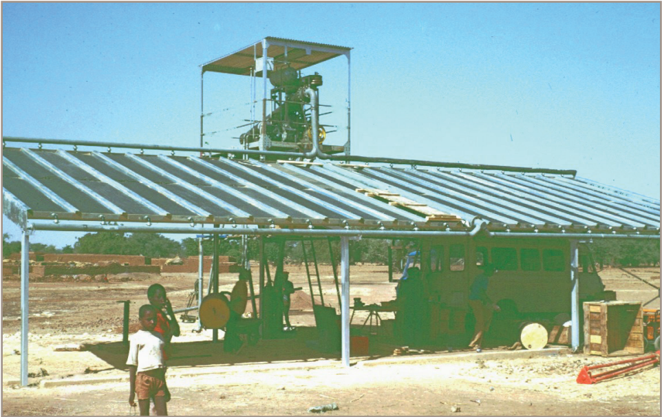
Image 2 - Pompe solaire Sofretes au Burkina-Fasso en 1978
