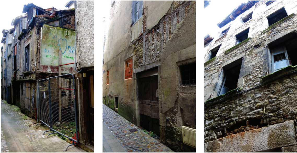
Fig. 7 : Les bâtiments tombent en ruine, faute d'entretien, et menacent de tomber sur la voie publique.
