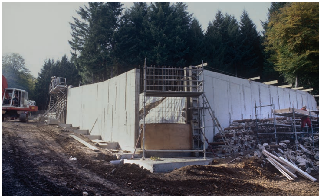
6. Bibacte, Mont-Beuvray. Le suivi des travaux de reconstruction de la Porte du Rebout. Chantier de construction du bastion nord en 1999 (cliché Bibacte/A. Maillier, n° 114568)
