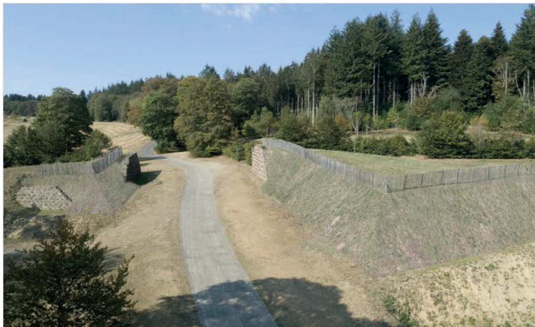
7. Bibracte, Mont-Beuvray. Le suivi des Travaux de reconstruction de la Porte du Rebout. Projet de reconstruction de la Porte du Rebout en 2021 (© Atelier multiple d'après cliché Bibracte/A. Meunier, n° 125462).
