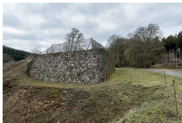
2. Bibracte, Mont-Beuvray. Le suivi des travaux de reconstruction de la Porte du Rebout. Le bastion sud de la porte en 2019 (cliché Bibracte/A. Maillier n° 121282).
