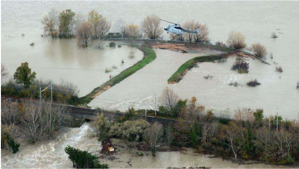
Figure 2 : Rupture des protections de l'une des trémies du remblai ferroviaire lors de l'inondation de 2003
