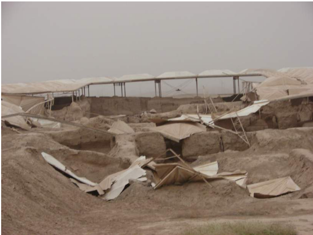
FIG. 15: Mari, palais de la ville II toiture endommagée, avril 2011, mission archéologique française de Tell Hariri-Mari, débris du toit.
