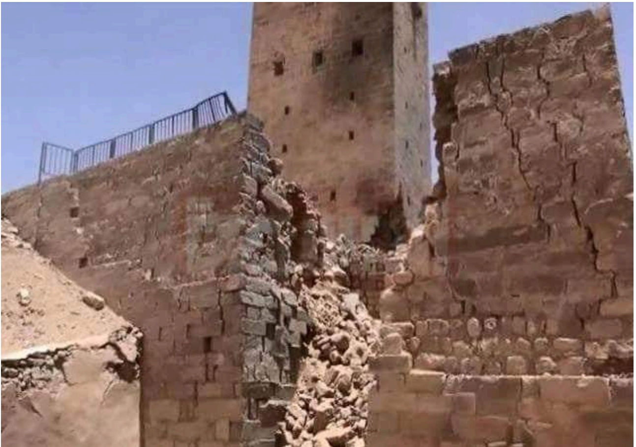
FIG. 20: Ma'rib, prise d'eau septentrionale du barrage antique endommagée par des bombardements aériens (Hussain Albukhaiti).
