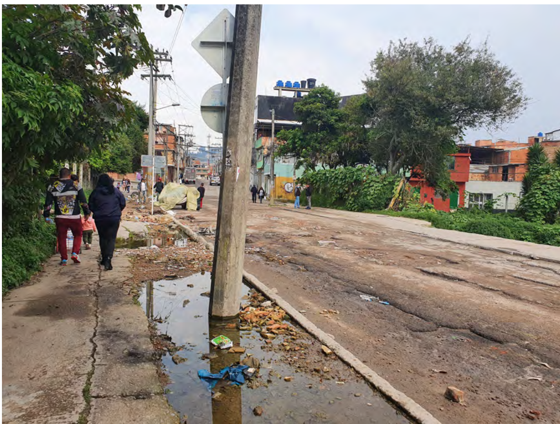
24. Chaussée et trottoir déformés par les intempéries et le manque d'entretien, dans le quartier de San Cayetano (Rincón de Suba) (Ducasse, 2022).
