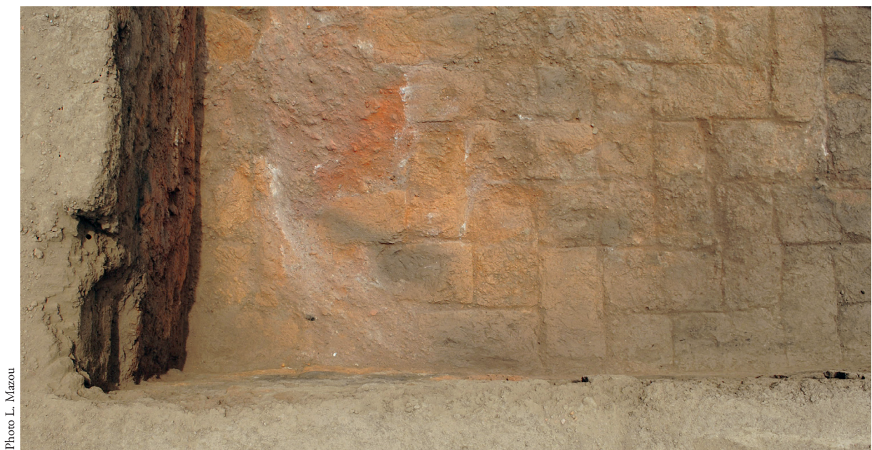
FIG. 9. P18, 2017. Phase 2, bâtiment 5, pièce 8. Traces d'incendie.
