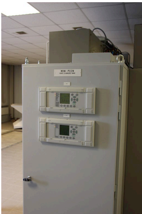
Photo 8 : Le mini-PCCN, Poste Contrôle Commande Numérique, cœur du dispositif d'hybridation
