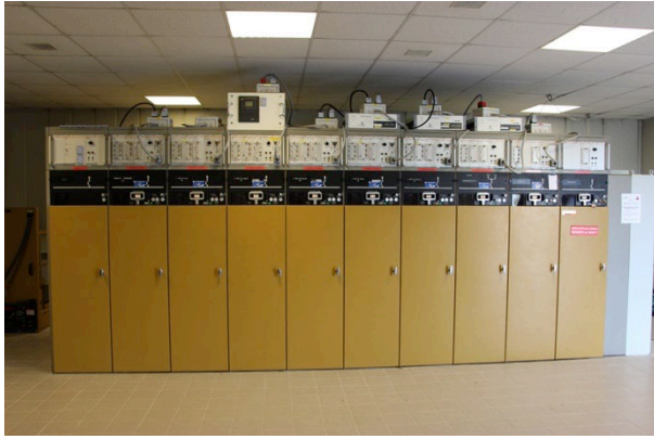
Photo 6 : Les modules numériques au dessus des départs de lignes classiques
