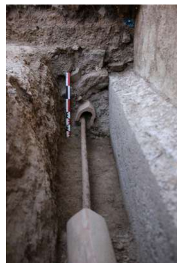
Fig. 212 : Réseau électrique sans ses chapeaux en terre cuite, coupe NO-SE (photographie : L. Aymard et J. Brangé).
