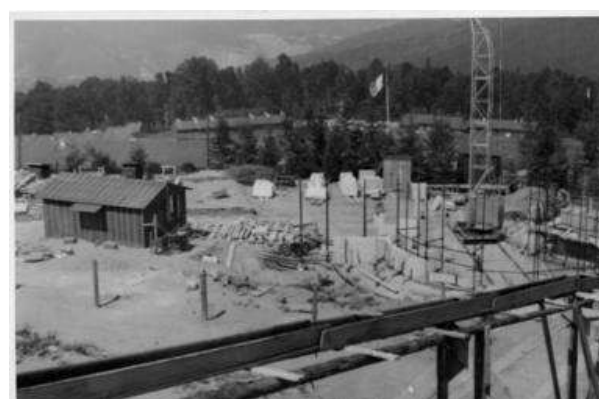
Fig. 66 : Photographies du chantier pendant la construction de la nécropole et du mémorial (IHOES).
