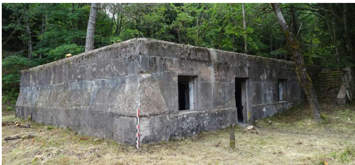
Fig. 182 : Pignon NO et gouttereau SO de la forge, campagne de prospection 2020 (photographie : J. Brangé).
