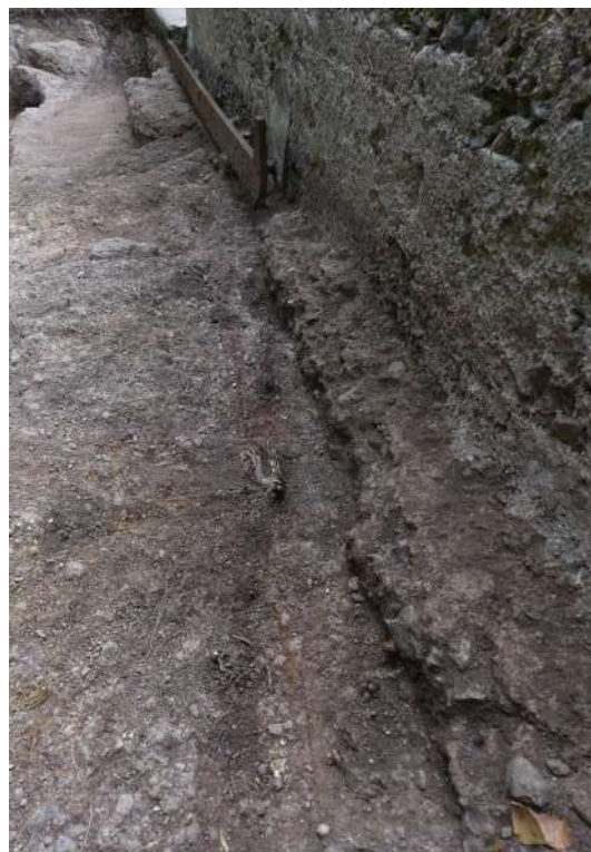
Fig. 353 : Détail de la fondation débordante de la halle depuis le sud-est (US 3314), SD3C (photographie : M. Landolt).
