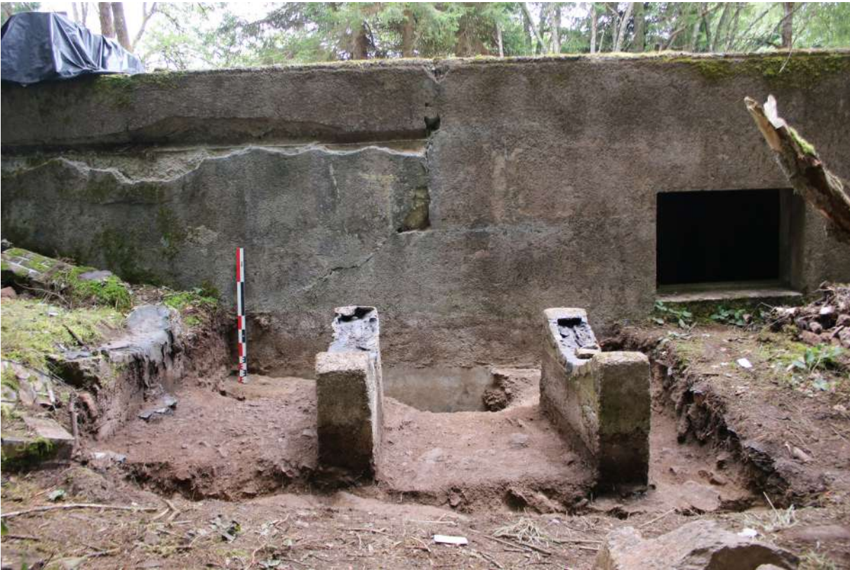
Fig. 265 : Mur gouttereau NE de la forge (3405) et plots en béton (3401, 3402 et 3403) (photographie : J. Brangé).
