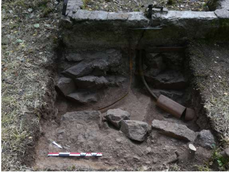
Fig. 375 : Réseau de mise à la terre et arrivée électrique au niveau du sondage 3D depuis le nord-est (photographie : M. Landolt).
