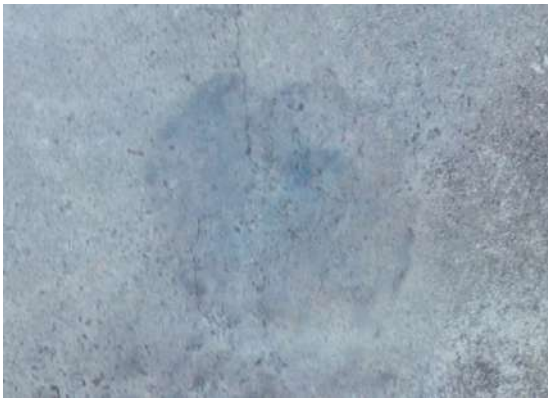
Fig. 378 : Tâche d'huile ou d'hydrocarbure sur la dalle de la halle 122 depuis le dessus (photographie : M. Landolt)
