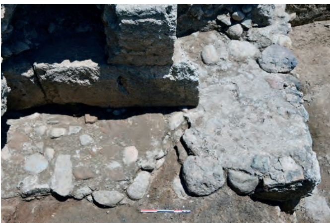
Fig. 60 : Vue depuis l'ouest de la fissure/lézarde, visible au niveau au sommet du mur MR3145. (photo : J. Bertaut)
