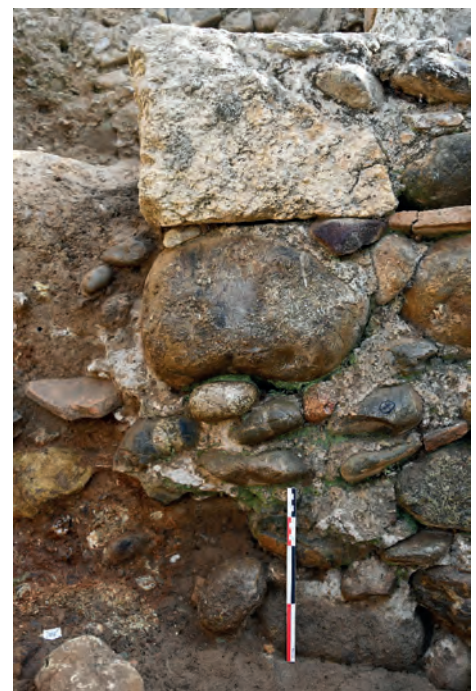
Fig. 57 : Vue de détail, depuis le sud, de la base de l'angle ouest du mur MR3145. Le ou les galets manquants ont fragilisé la construction. (photo : J. Bertaut)
