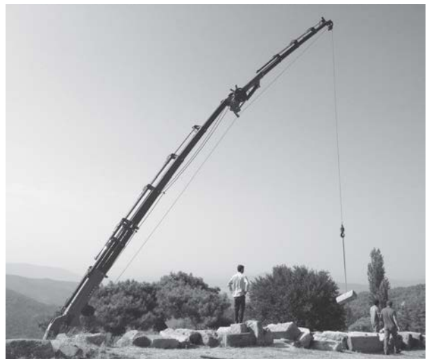
Fig. 110 : Enlèvement des blocs de la terrasse sud à l'aide d'un camion-grue (O. Henry).
