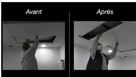
Figure 3. Exemple de transformation mise en place pour améliorer l'accès aux centrales d'air
