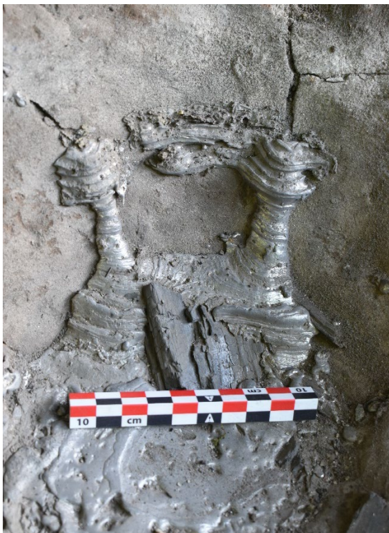
Figure 94, plomb accumulé au niveau des fissures de la structure
